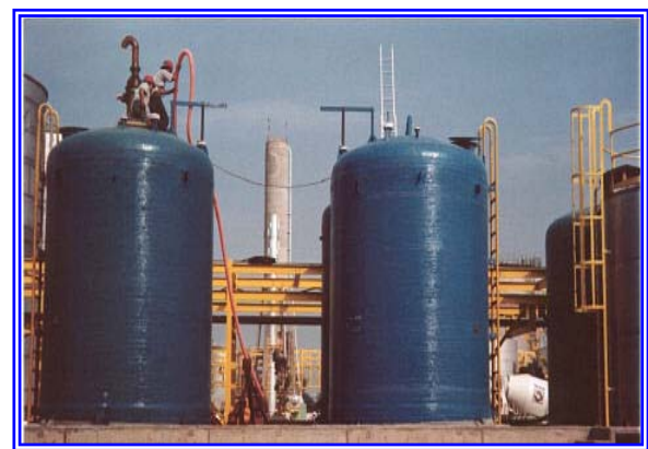
Tanques de almacenamiento PVDF/FRP
