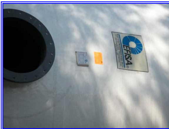
Detalle de registro de acceso en tanque de PVC/FRP
