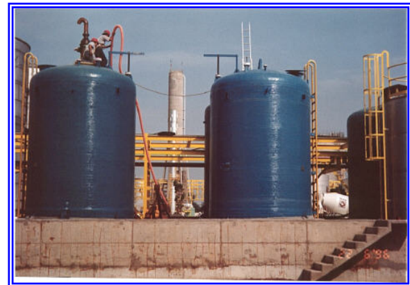
Tanques de almacenamiento PP/FRP
