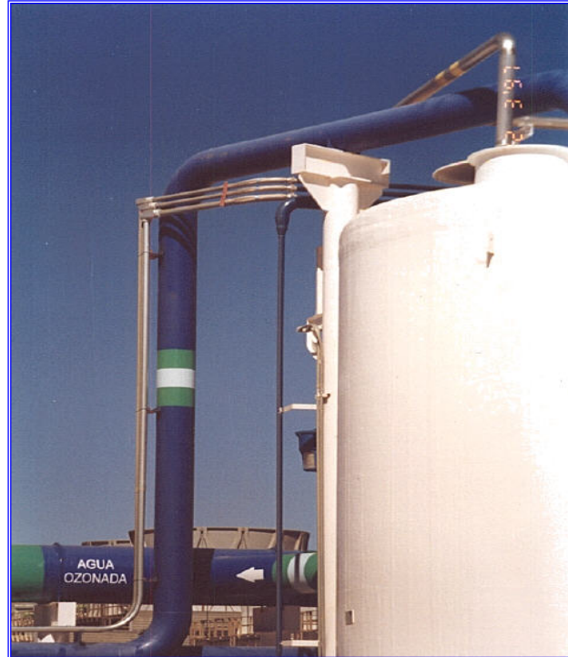
Tubería de 24" ø, agua purificada para cerveza
