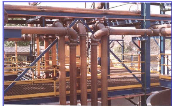
Tuberías de 4" a 12"Ø para productos químicos
