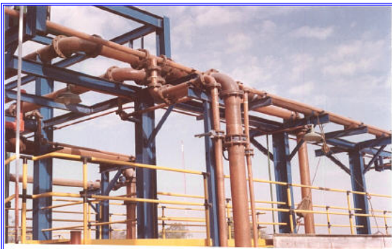
Tuberías de 4" a 12"Ø para productos químicos
